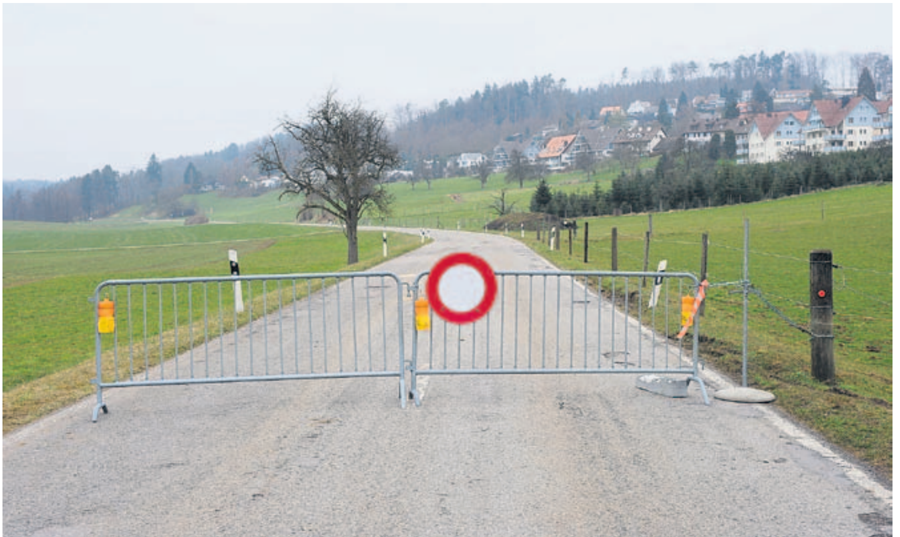
Die marode Eigentalsstrasse zwischen Oberembrach und Nürensdorf ist seit Januar gesperrt. Eine Sanierung ist beschlossen, nicht aber, wie es danach weitergeht. Bild: Heinz Diener
